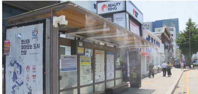
그림 55. 버스승강장 쿨링포그 설치 사례
