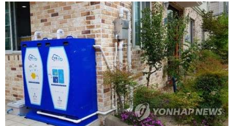
그림 58. 울산시 소규모 빗물이용시설 설치사례
